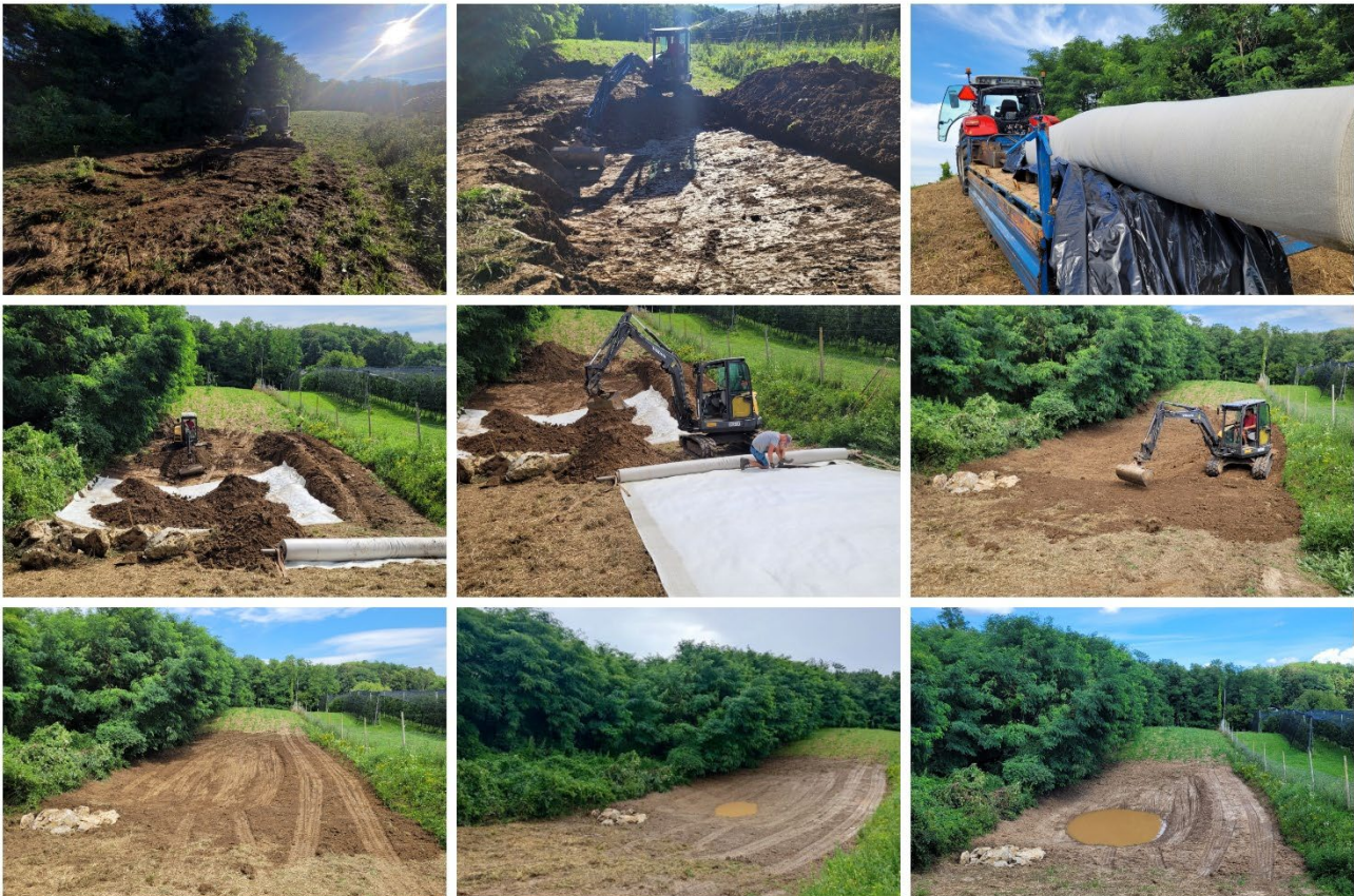
Slika 34: Vzpostavitev mlake in skladnjaka na zemljiščih Kmetije Škof nad intenzivnim nasadom jabolk (foto: Aja Zamolo, 1. 8. 2023).
